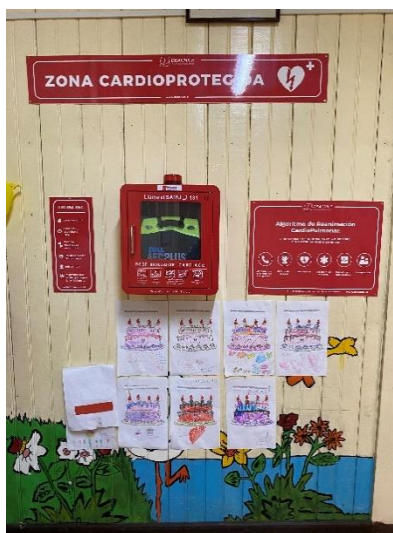
Equipo DEA en 1er Piso
